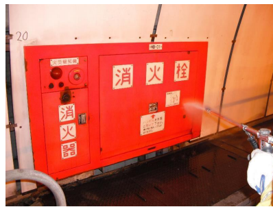
トンネル非常用設備
